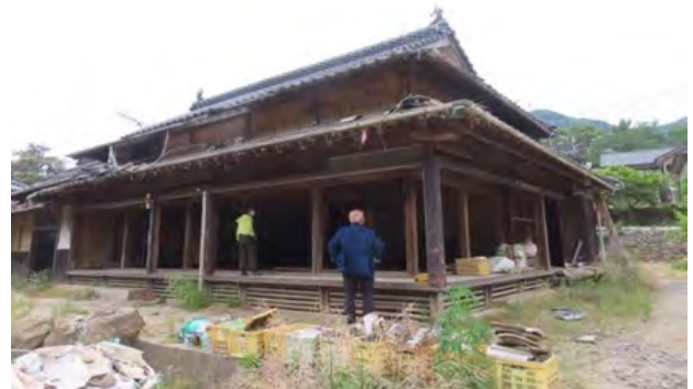
屋根・外壁・建具破損
