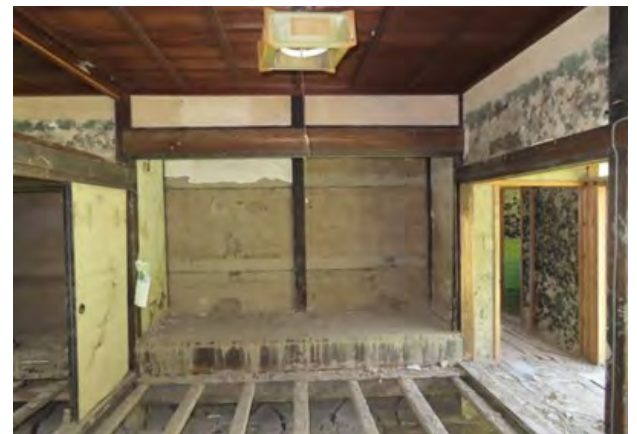
垂れ壁浸水・土壁破損
