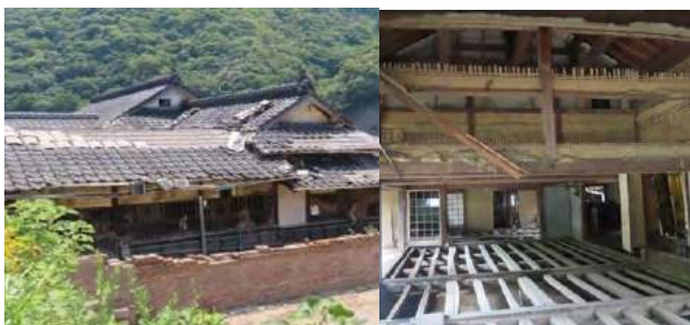
屋根・外壁・レンガ塀破損
