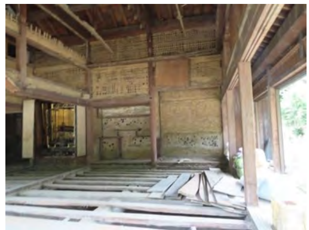
土壁・天井・床破損
