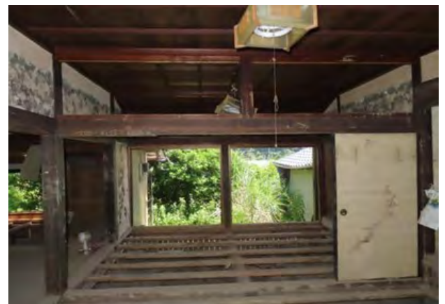
建具・床破損
