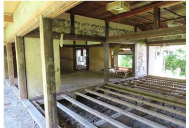
垂れ壁浸水・建具・床破損
