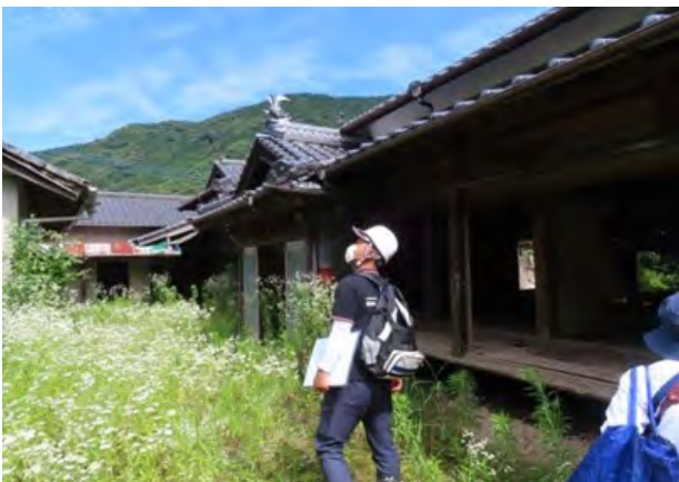
外観（建具破損）
